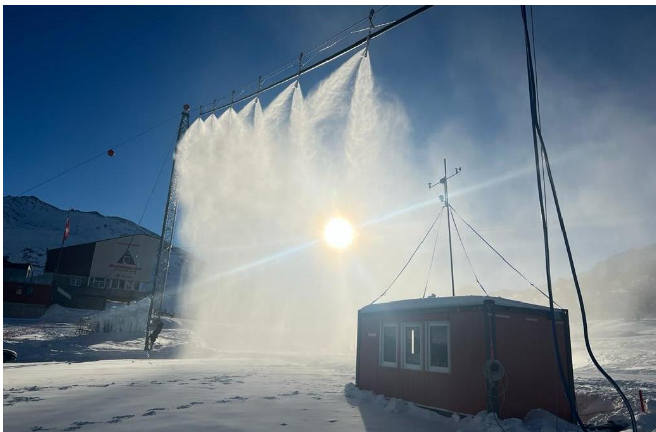
Abbildung 3 Testanlage 2021/22 für das Schneiseil an der Talstation Diavolezza
